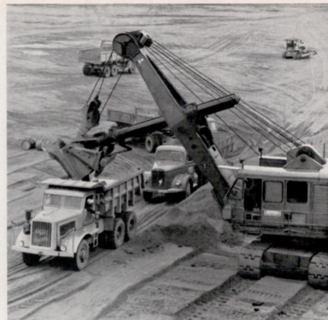
Pausenlos — in Tag- und Nachtschicht — werden hier Großraumwagen geladen, 8000 m 3 Erde müssen täglich angefüllt werden.
