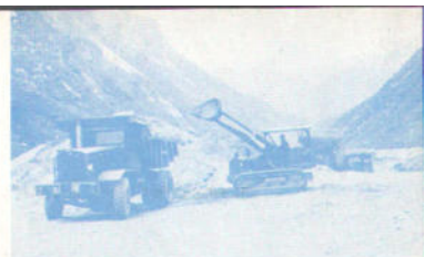
International TD-9 Raupenschlepper mit Frontlader sind zum Laden von Kies und Geröll eingesetzt, das zu Beton verarbeitet wird.
